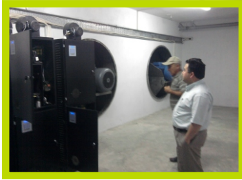
SOĞUTMA ,HAVALANDIRMA FANLARI
